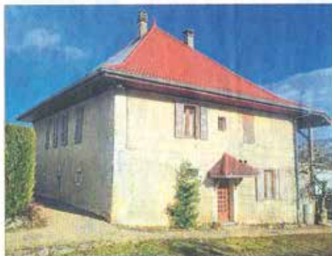
Le presbytere, patrimoine communal (qui, avec son toit à coyaux, daterait de 1751), sera réhabilité, à des fins de conservation et d'optimisation de l'immobilier communal. Photo Le DUC.G.V.
